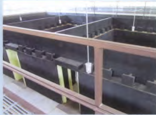
Figuur 10: Een voorbeeld van vaste kogelwerende binnenwanden van een schiethuis. (Foto: ministerie van Defensie).
